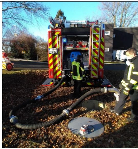
Löschwasserentnahme über Löschwasser-Sauganschluss
